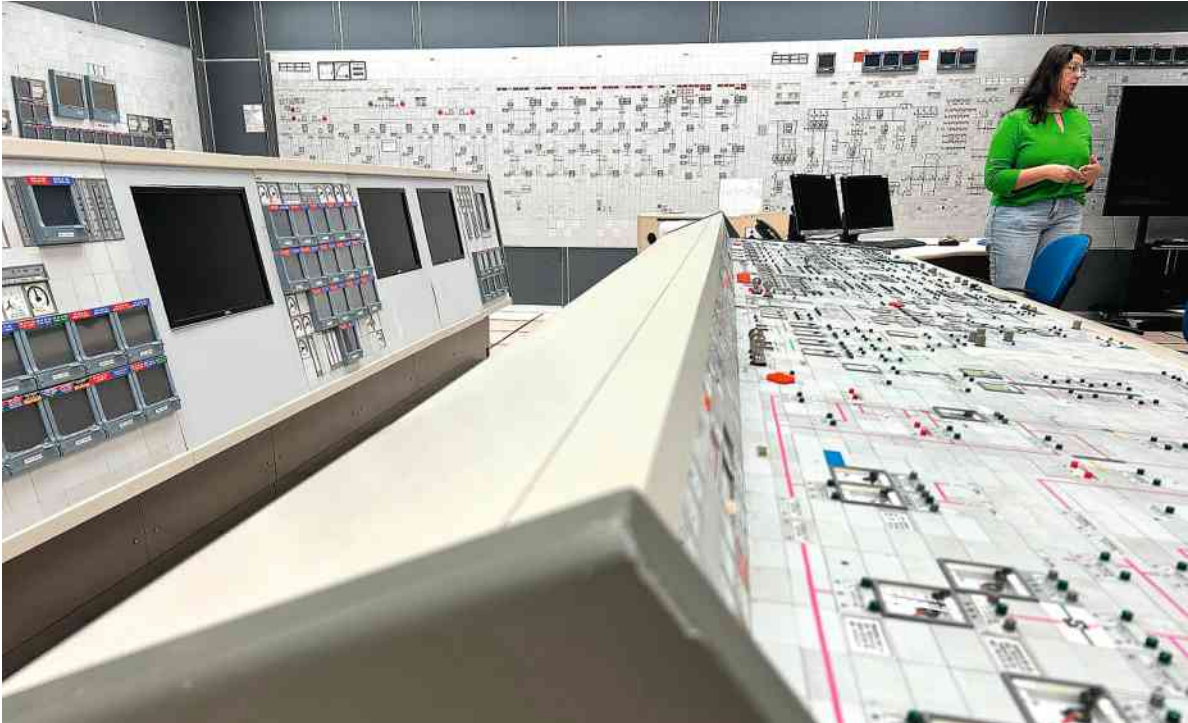
Painel de controle da usina de Angra 1, gerida pela Eletronuclear Alexa Salomão - 27.nov.24/Folhapress
